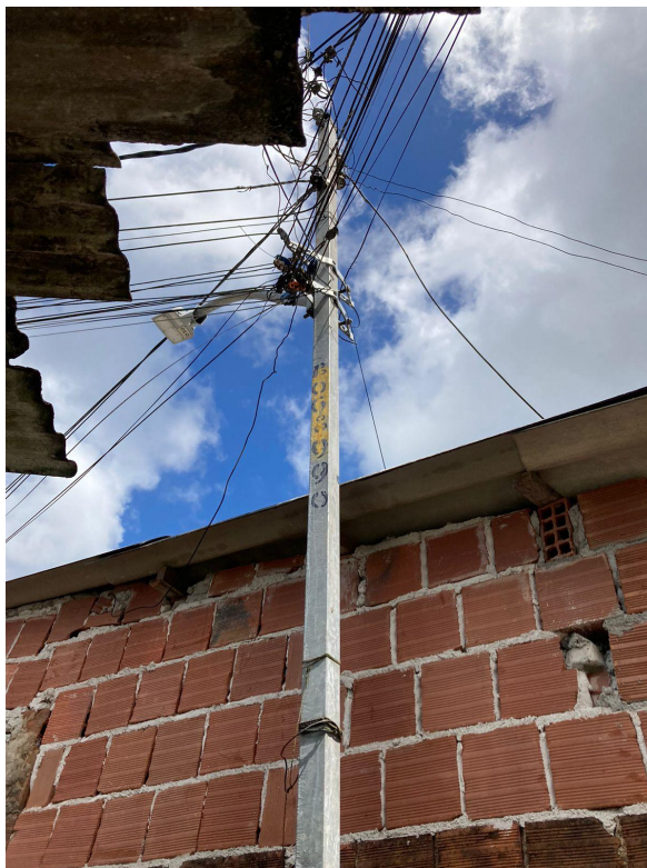
Poste sito no Beco do Óleo, Vila Arraes, na Várzea.
