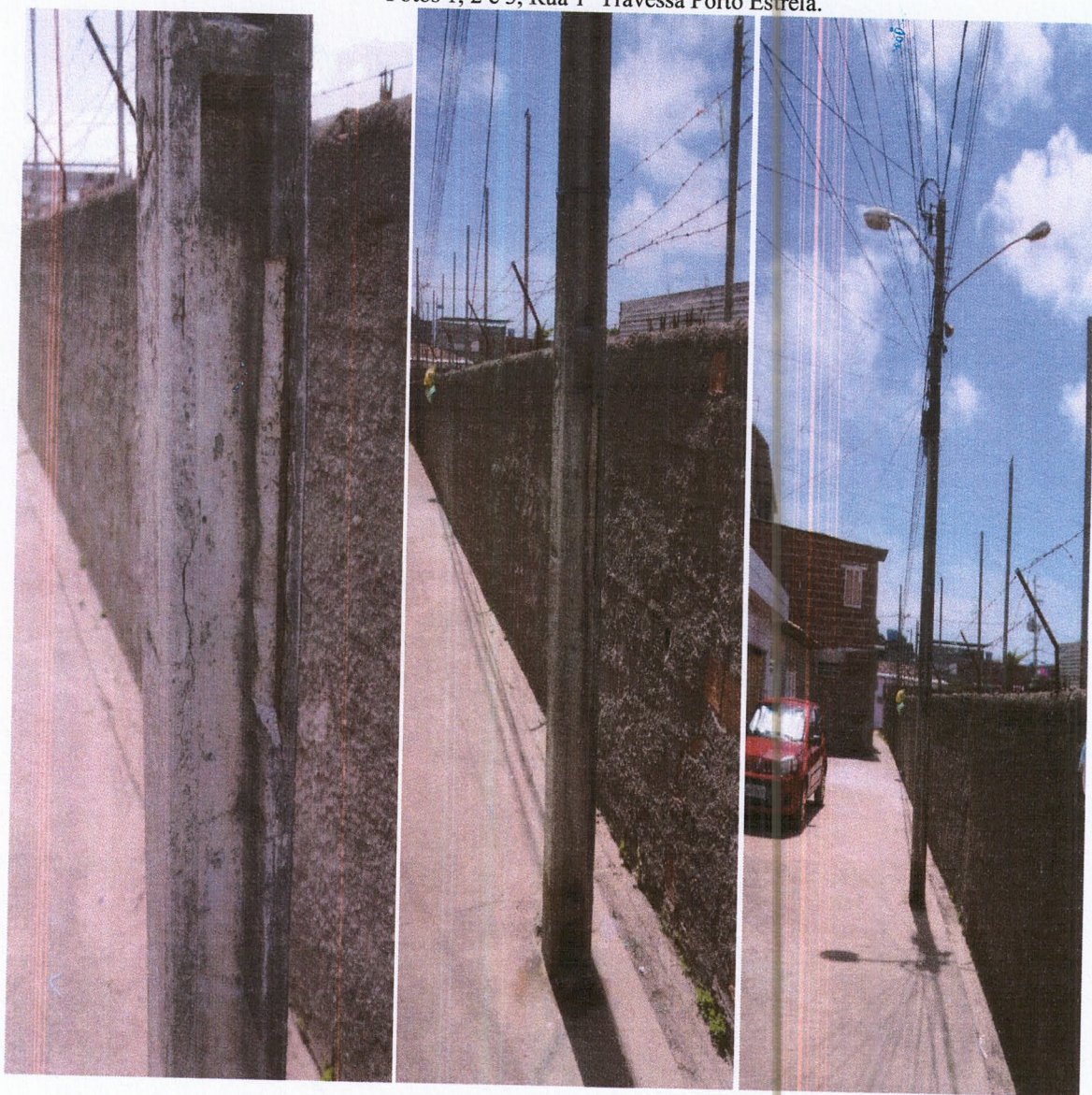
Fotos 1, 2 e 3, Rua 1º Travessa Porto Estrela.
