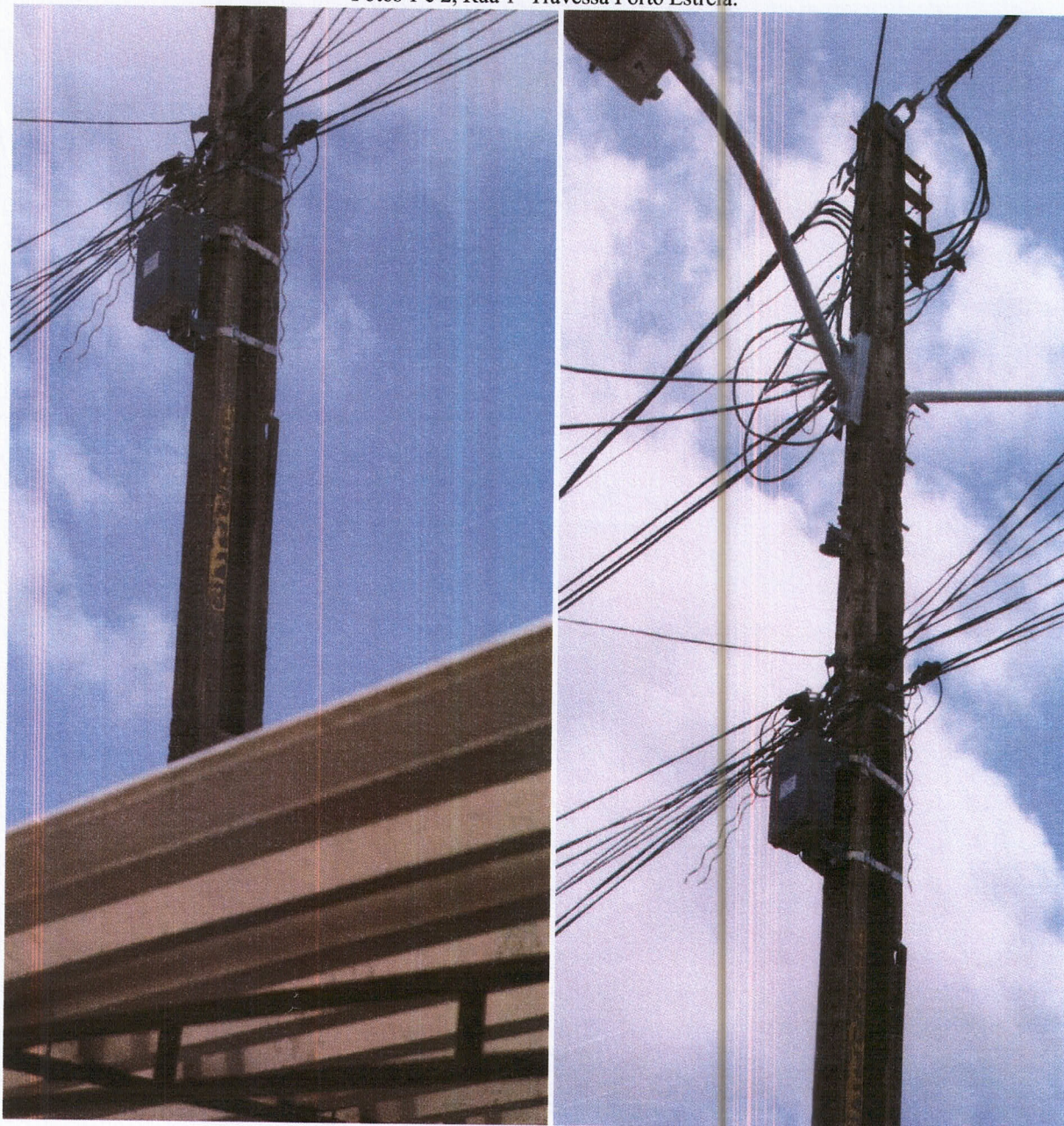
Fotos 1 e 2, Rua 1º Travessa Porto Estrela.
