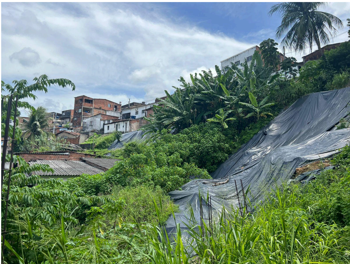
Imagem 01- Barreira localizada na Rua Gonçalves Crespo, UR-1, nº 52, Recife - PE, 51280-370.
