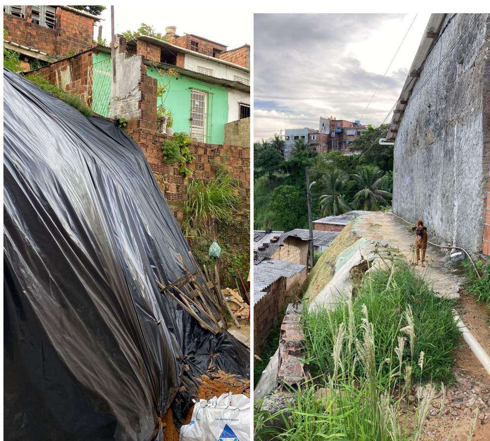
Barreiras na 1ª Travessa Av. Santa Fé, UR-2.
